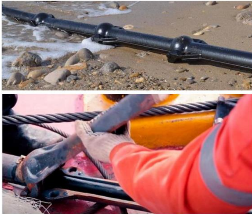
Figura 5. Imagens do elemento de infraestrutura de proteção de um cabo subaquático ("split pipe").
